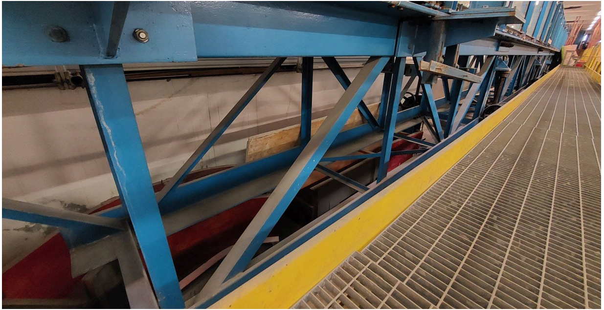
FIG. 11: struttura di supporto del canale idraulico
