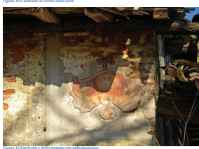
Figura 19: Particolare della facciata con intonaco scrostato
